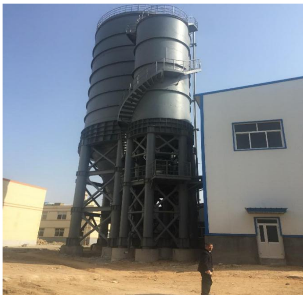
图：河西金矿膏体浓密机现场
