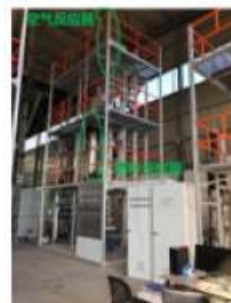
百吨级煤炭化学链燃烧/气化中试装置
